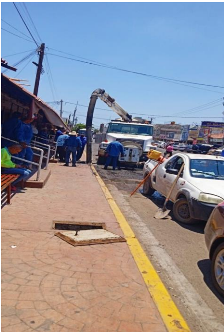
03 / 07 / 23 personal de Oomapas realizando mantenimiento y servicio registro ubicado banqueta del mercado municipal García Morales.
