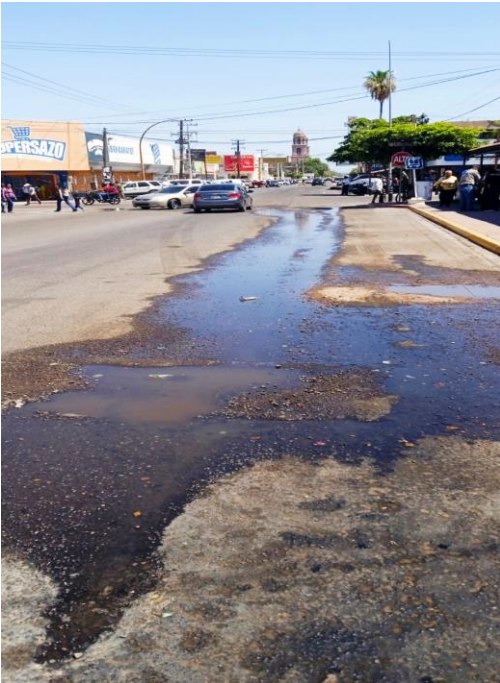
03/ 07/ 23 fuga de agua de drenaje del registro ubicado banqueta del mercado municipal García Morales
